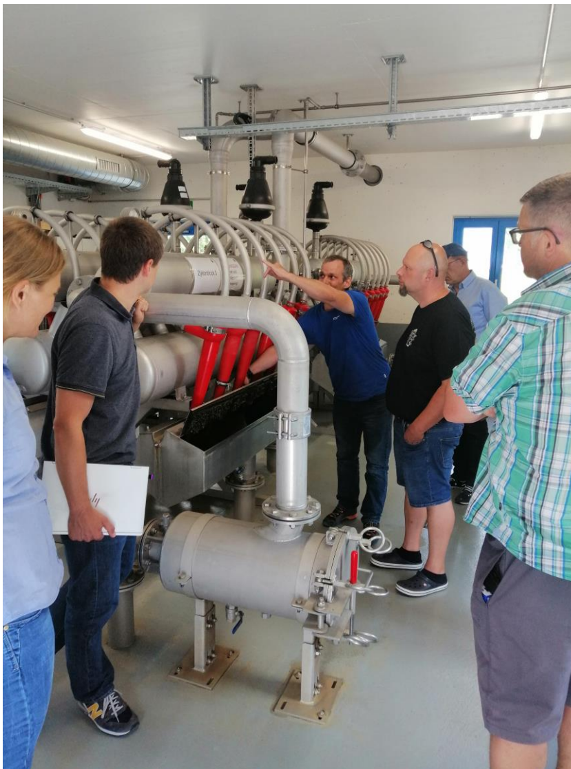
Besichtigung einer Hydrozyklon-Abwasserreinigungsanlage in Bilten (S-Select Verfahren mit granuliertem Schlamm)
